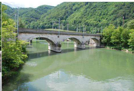
T142 D: Savinja v Zidanem mostu, vpliv zaježitve – pogled proti izlivu v Savo
