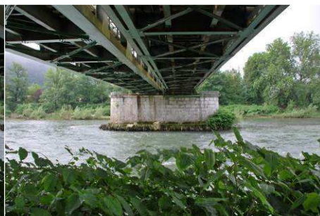
T125: Železniški most v Pogoniku, kamnit mostni opornik je dodatno zavarovan s kamnitimi bloki in tirnicami.
