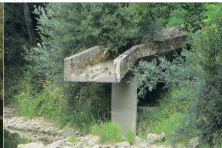
T135a G: Betonski zrust gorvodno od TET
