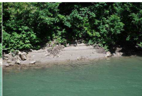
T134: Levi breg pri Mitovškem slapu ni utrjen, na desnem bregu je betonski zid, ki podpira cesto
